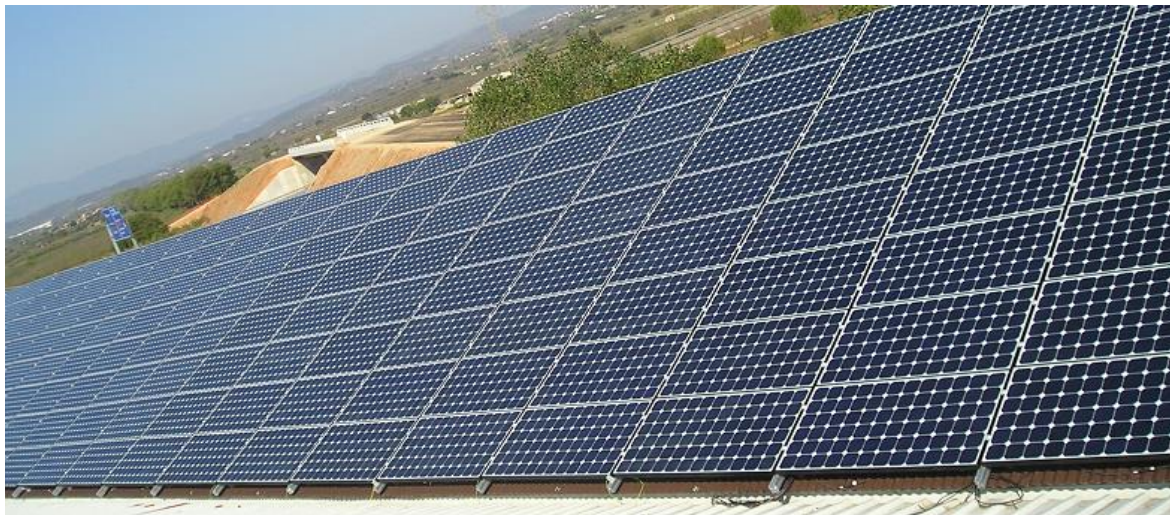
Ejemplo de una instalación finalizada
