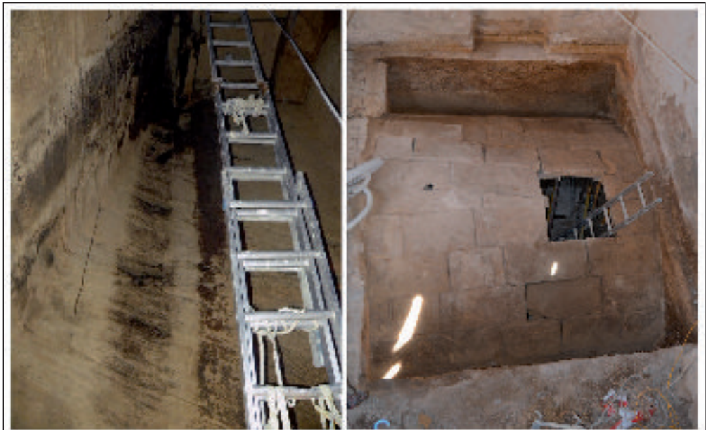
Figura 9. Depòsit documentat al subsòl de l'habitació 0M (esquerre) i pedrera coberta amb volta de marès documentada al subsòl de l'habitació 0Q (dreta).
