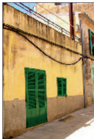
Il·lustració 26: Façana en fase D.
